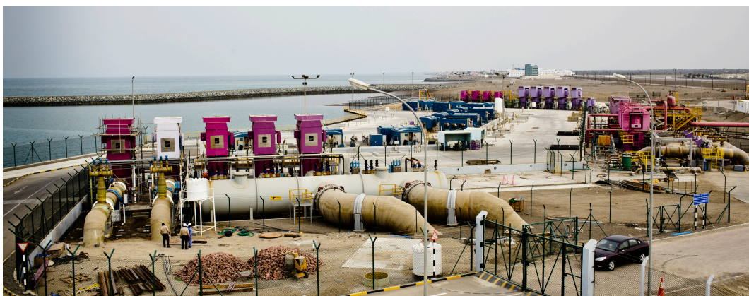
Installations de collecte d'eau de mer dans la zone portuaire de Sohar (Oman)
